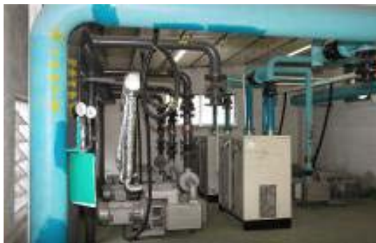
中央真空泵机组 1
