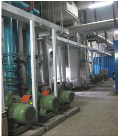
冰蓄冷空调机组 1
