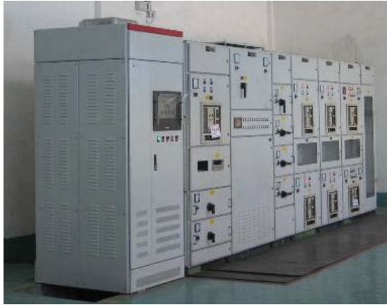
电力监控系统机组 1
