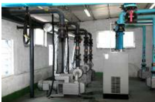
中央真空泵机组 2
