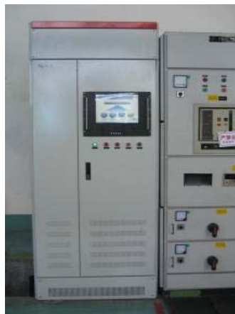
电力监控系统机组 2
