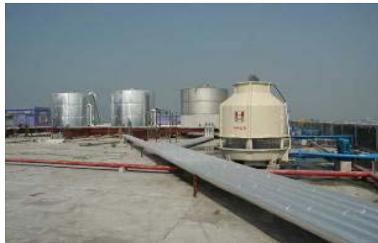
余热回收保温储水罐
